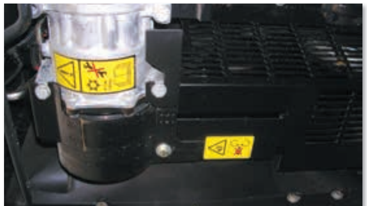
Isikrini sokhuseleko se-pulley.
